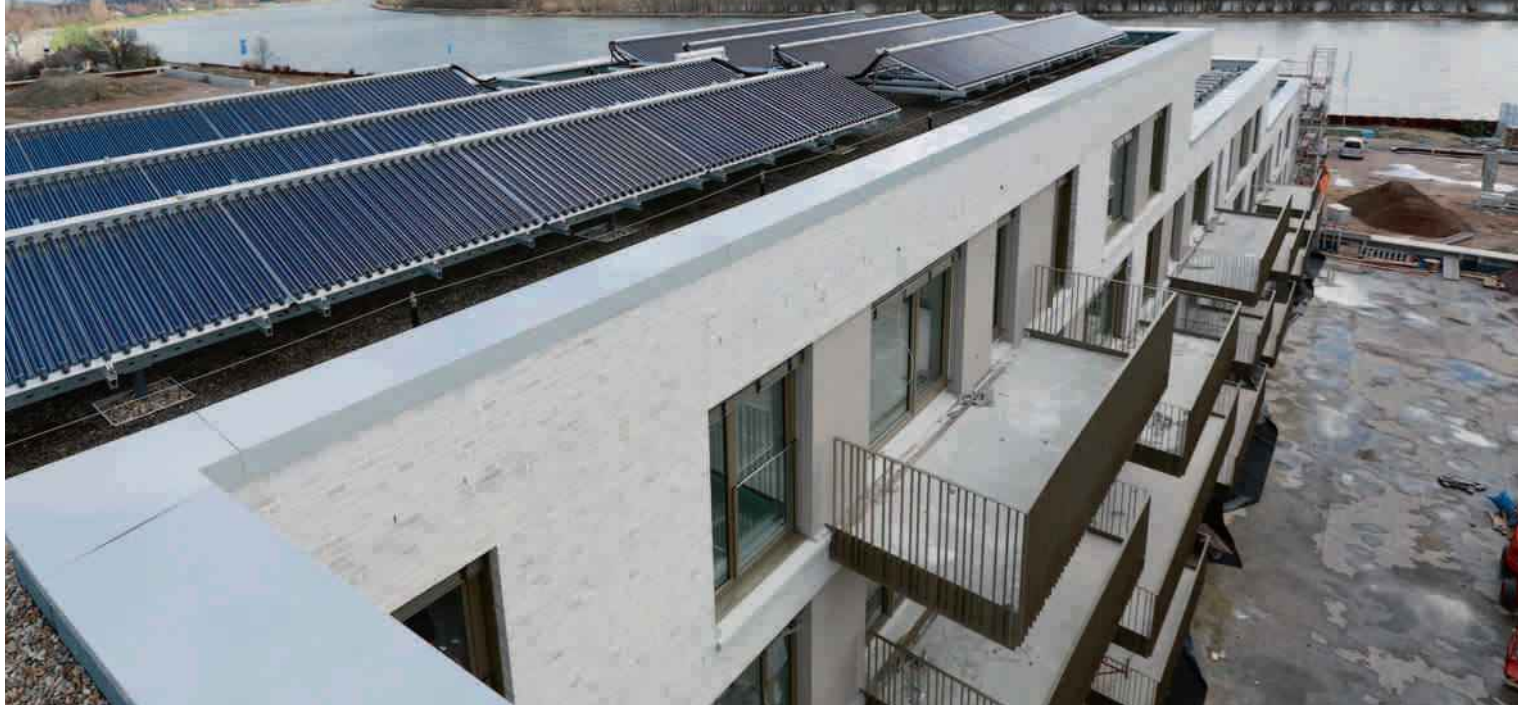
Kollektoranlage mit einer feuerverzinkten Unterkonstruktion und den Aufdachständern von Ritter XL Solar
