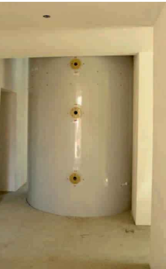
Der 10,5 m 3 fassende Wärmespeicher besteht aus Glasfaser verstärktem Kunststoff.
