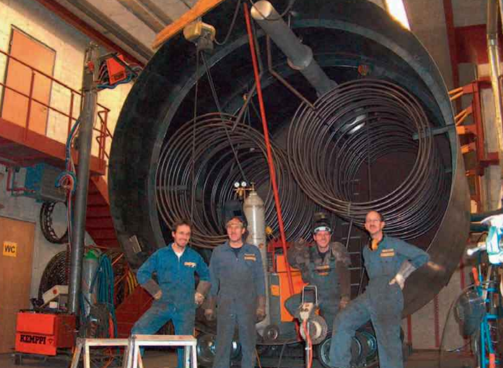
Der Speicher des ersten vollständig solarbeheizten Mehrfamilienhaus hat ein Volumen von 205 m 3 .
