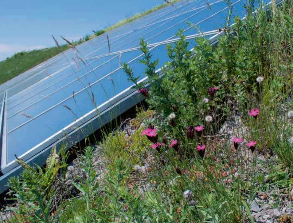
Sonnenkollektoren auf dem Lärmschutzwall von Crailsheim.
