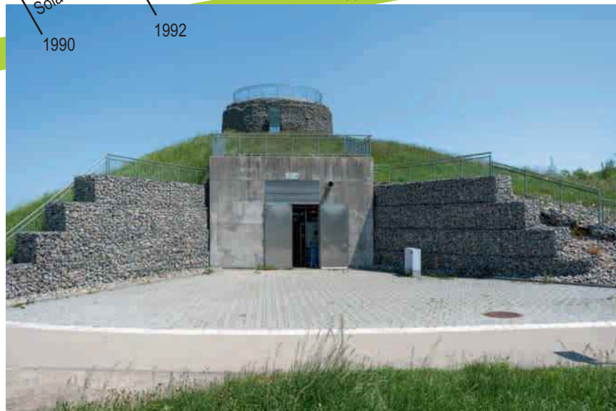
In Crailsheim speichert ein Erdsonnen-Saisonalspeicher mit 37.500 m 3 Inhalt die Solarwärme vom Sommer bis in die Heizsaison.
