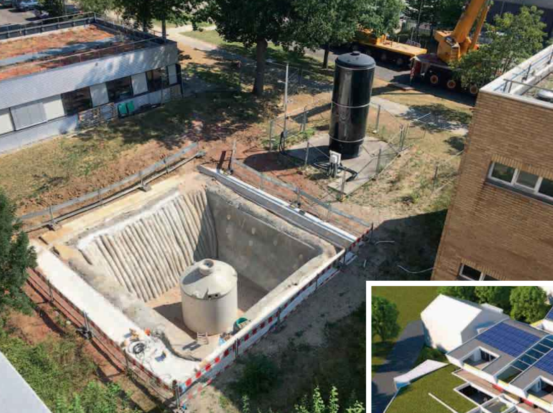
Eisspeicher im Außenlabor am IGTE
