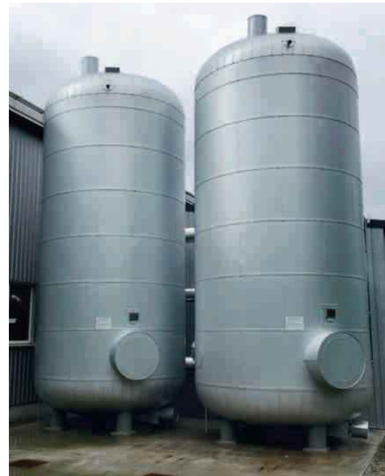
Die beiden Pufferspeicher in Breklum haben ein Volumen von jeweils 44 Kubikmetern.
