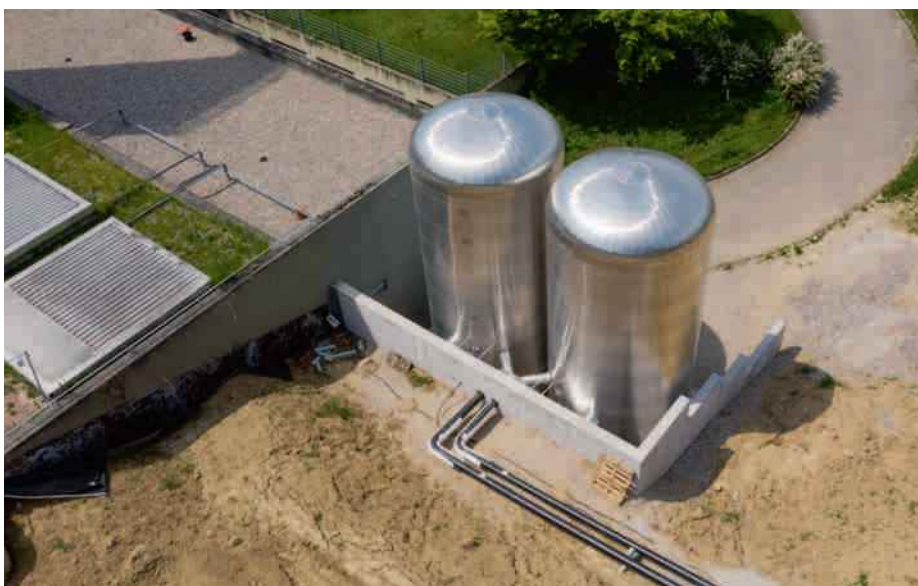
Zwei Speicher mit jeweils 100 m 3 Fassungsvermögen überbrücken bewölkte Tage.
