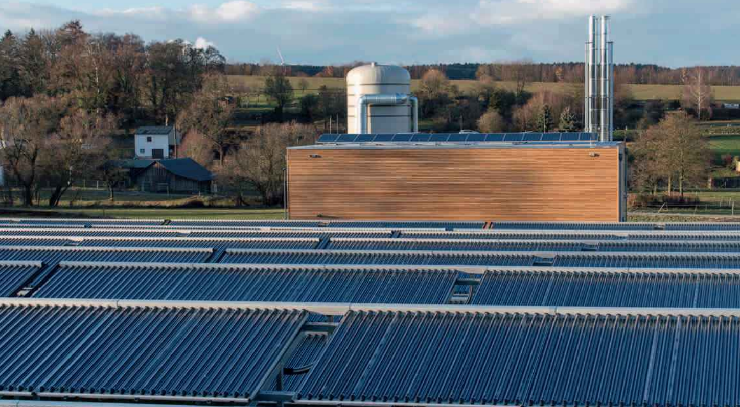
Das Solarheizwerk von Ellern hat eine Leistung von rund einem Megawatt und deckt damit die Sommerlast komplett ab.
