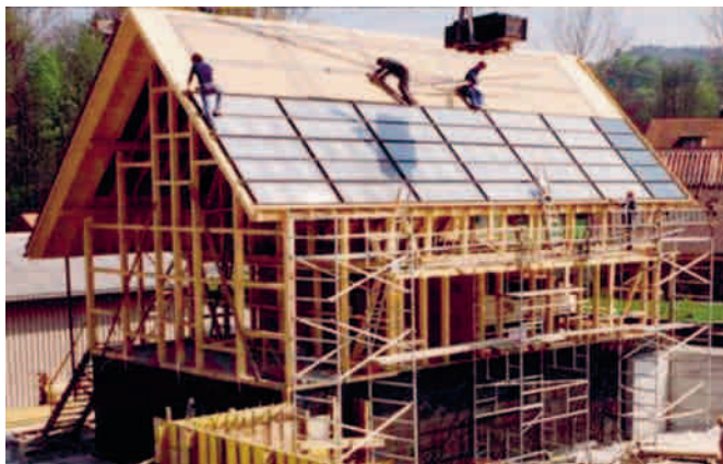
Mit diesem Haus wollten Erwin und Josef Jenni zeigen, dass es möglich ist, ein Gebäude rund ums Jahr nur mit Solarenergie zu beheizen.
