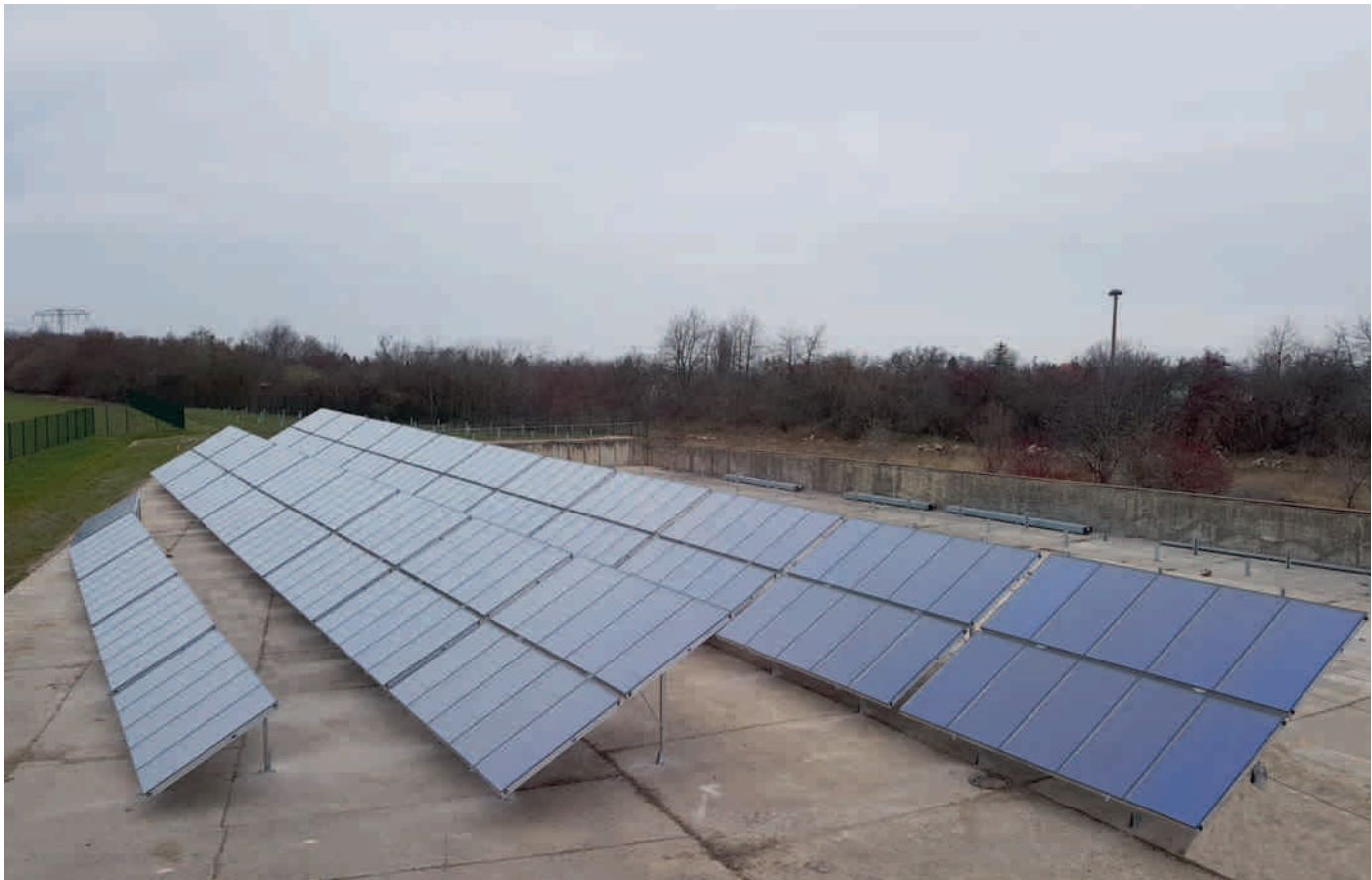
Solare Fernwärmeversorgung in Erfurt: Die Sonnenkollektoren finden auf einem ehemaligen Kohlelagerplatz Platz.
