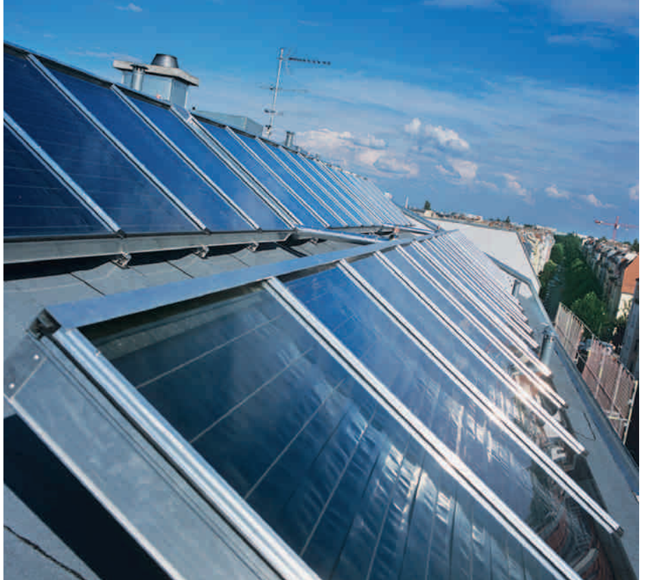
Oben: 43 Quadratmeter Kollektorfläche produzieren Wärme für zwei Mehrfamilienhäuser in Berlin-Prenzlauer Berg.
