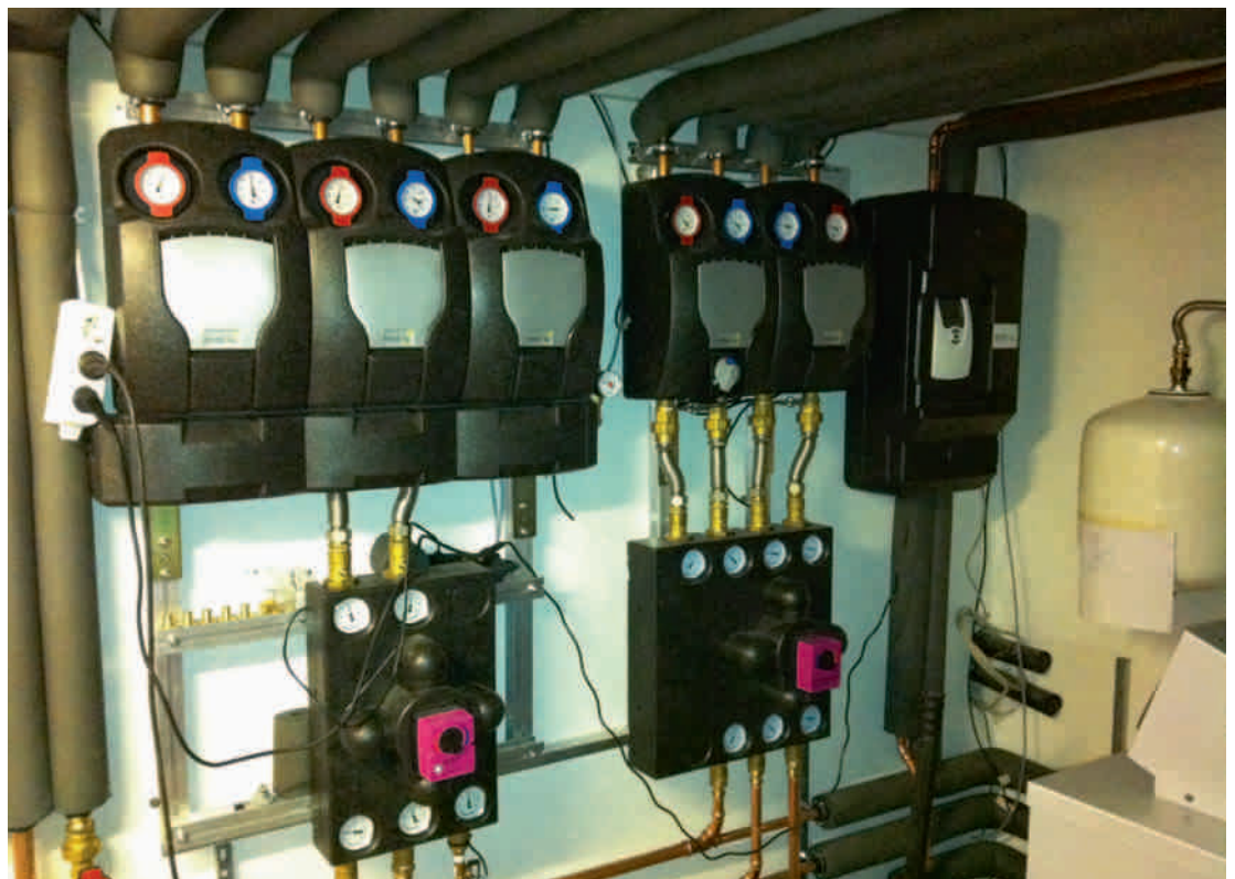
Übersichtlicher Haus-technikraum: Pumpengruppen trennen die Erzeugung und die Verteilung der Wärme. Eine Frischwasserstation stellt warmes Brauchwasser bereit.
