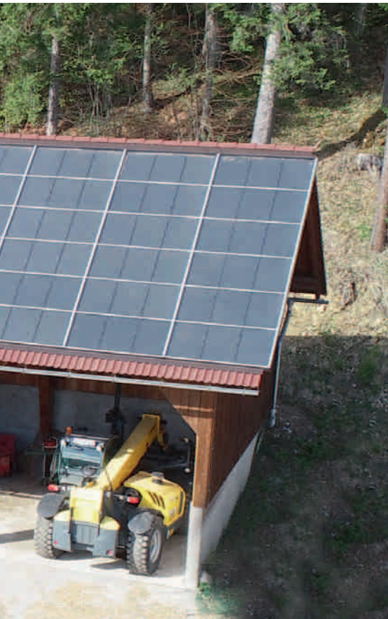
Eine Kollektorfläche von 193 Quadratmetern wurde auf diesem Dach für die Hackschnitzeltrocknung installiert.
