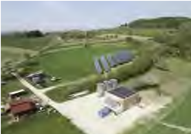
In Liggeringen musste die Solarthermieanlage aus Landschaftsschutzgründen hinter einer Hecke versteckt installiert werden.
