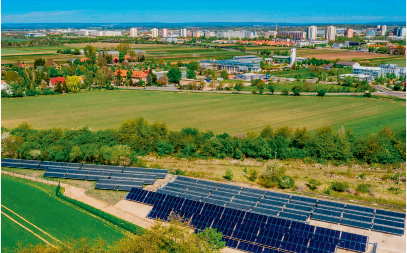
Diese Solarthermieanlage speist mit maximal 1,2 Megawatt Leistung in das Fernwärmenetz der Stadt Erfurt ein. Sie besteht aus 1.155 Quadratmeter Vakuumröhrenkollektoren und 550 Quadratmeter Flachkollektoren.
