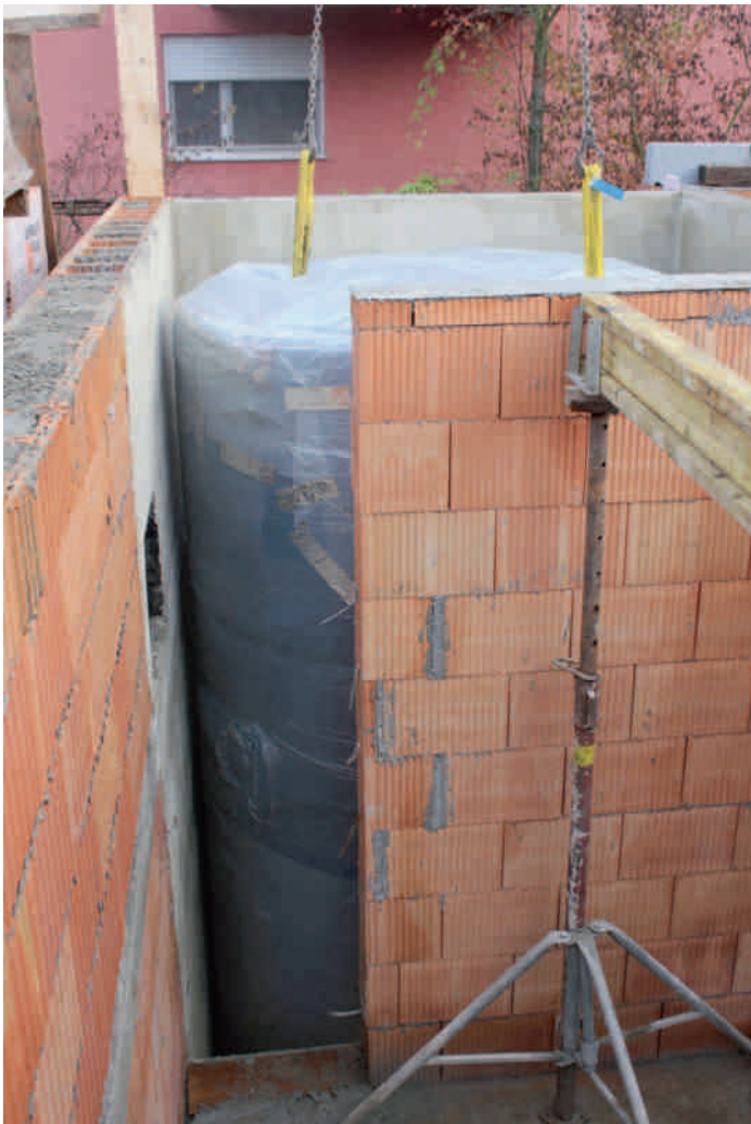
Der Wärmespeicher an seinem Aufstellort, perfekt eingepasst und aufgestellt.
