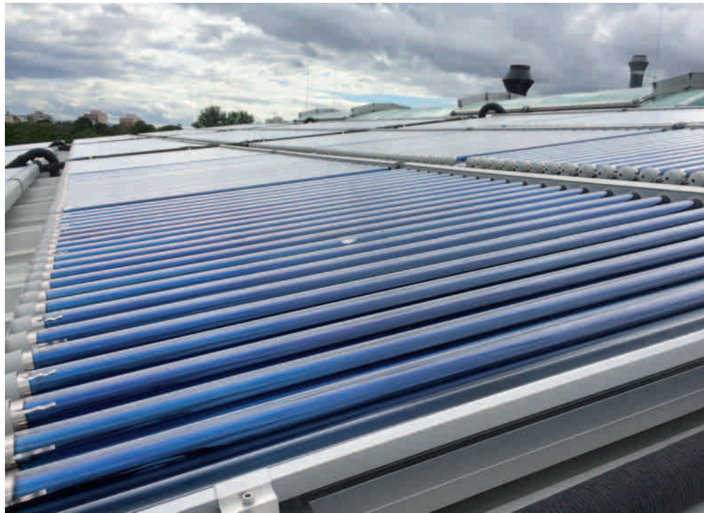
Diese solare Prozesswärme-Anlage im Lampertheim liefert Wärme für die Galvanikbäder einer Metallveredlung.
