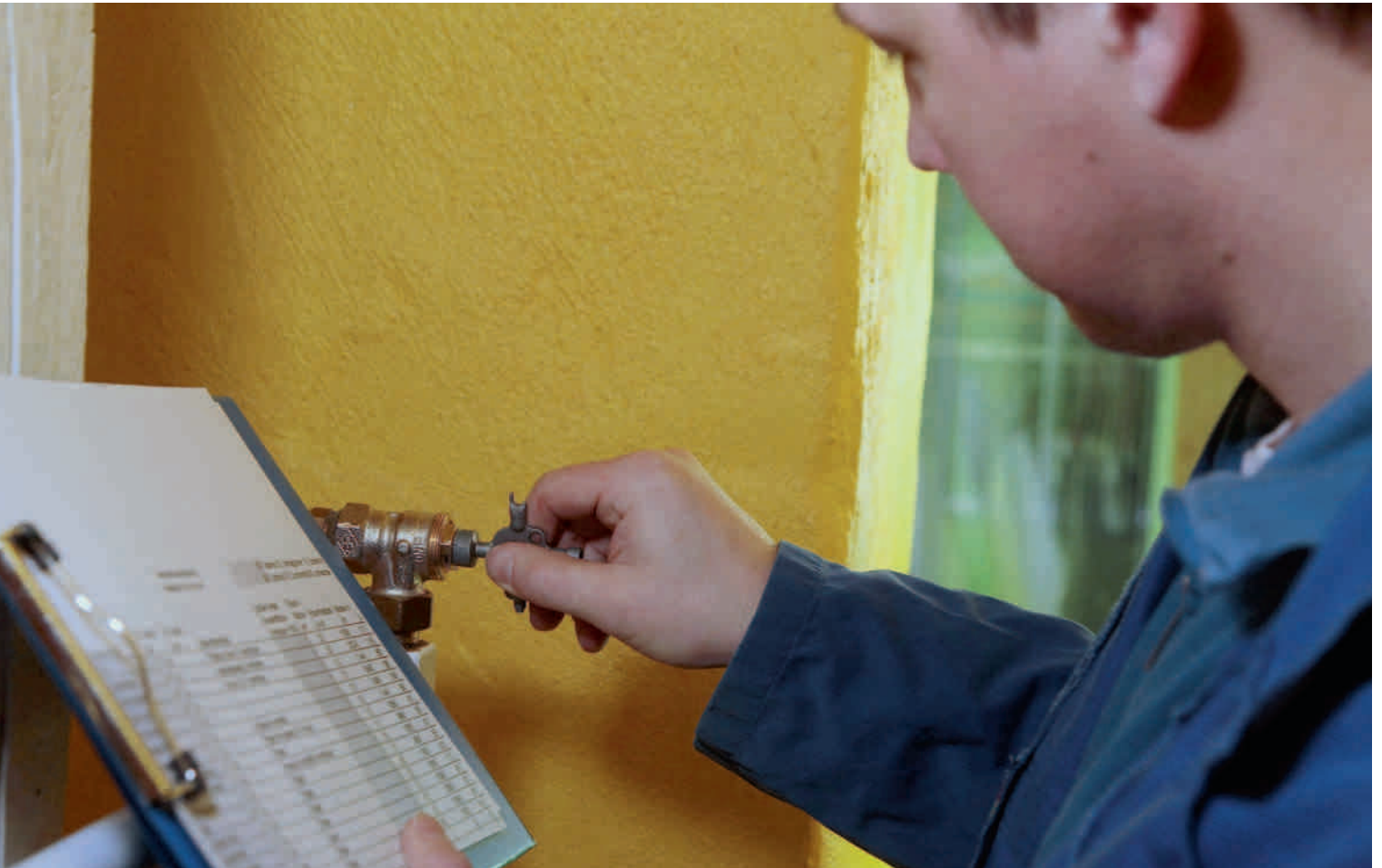
Das Einstellen des Thermostatventils beim hydraulischen Abgleich sichert den effizienten Betrieb von Brennwertkesseln. FOTO: WWW.CO2ONLINE.DE/ALOIS MÜLLER
