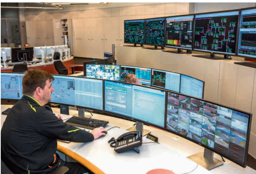
Die Mitarbeiter im Leitstand des städtischen Heizkraftwerks in Potsdam werden künftig auch die Solarthermie im Blick haben. FOTO: EWP
